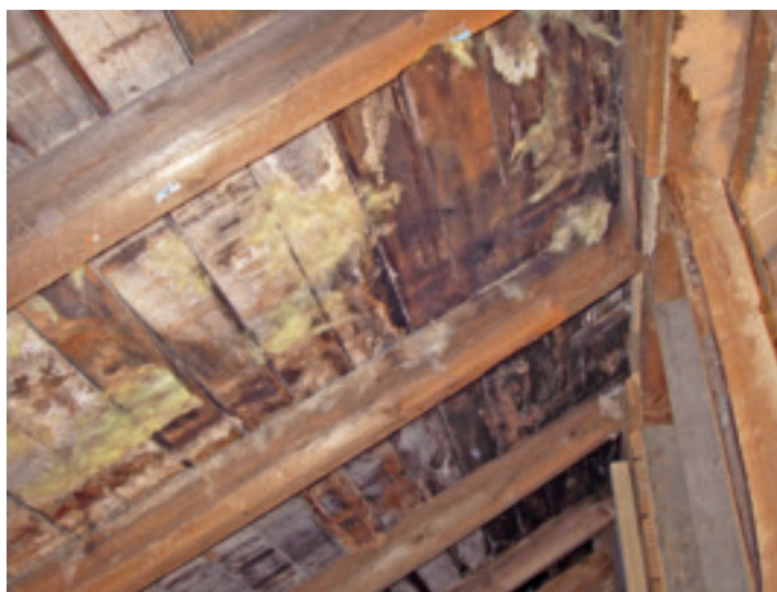
Suoraan vesikatteen aluslaudoitusta vasten asennettu mineraalivilla esti rakenteen tuulettumisen ja aiheutti lahovaurion.
