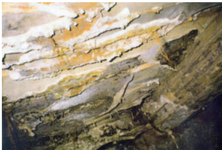
Alapohjan tuuletuksen laiminlyöminen voi pahimmillaan johtaa lattiasienen pesiytymiseen taloon.
