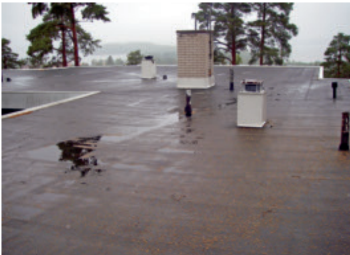
Vettä ei vielä seisokattolla paljon, mutta vaurioitumisriski on olemassa.
