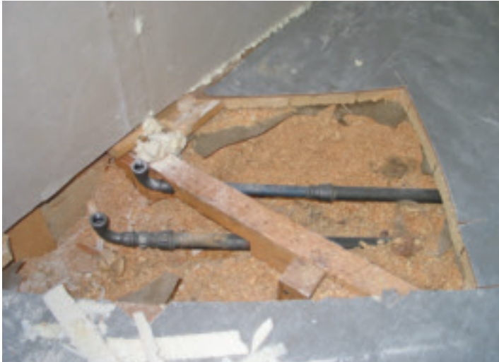
Vaihtoehto 2. Lattiaa avattaessa voidaan myös liitosputkien kunto tarkastaa.
