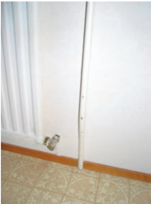
Vaihtoehto 3. Putket on saatu siististi osittain seinälevyn ja jalkalistan taakse.
