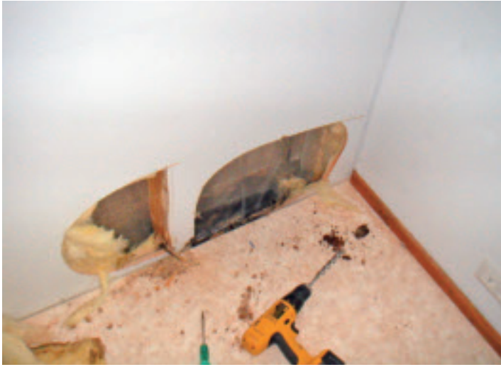
Rakenteen avaaminen paljastaa pitkälle edenneen valesokkelirakenteen vaurion.
