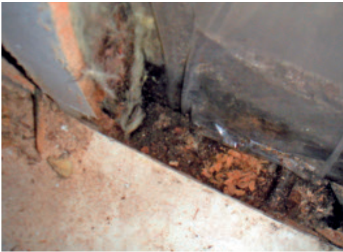
Korjauksiin on ryhdyttävä pikimmiten.
